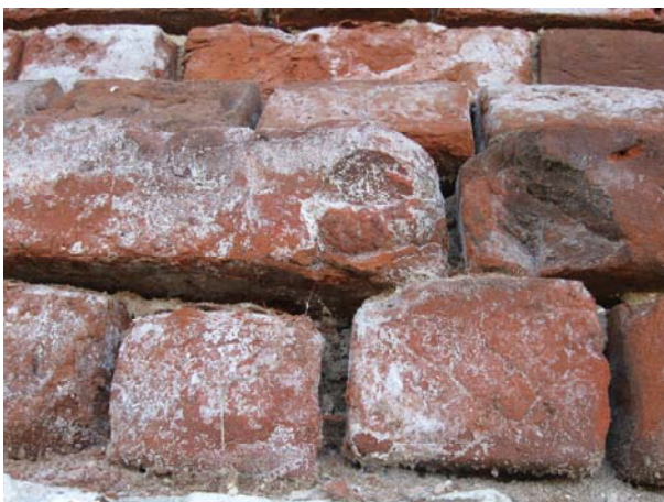
Рис. 2. Высолы на поверхности стены
