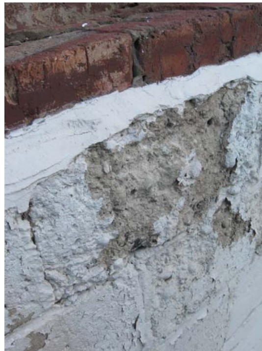
Рис. 3. Рыхлая поверхность кирпича
