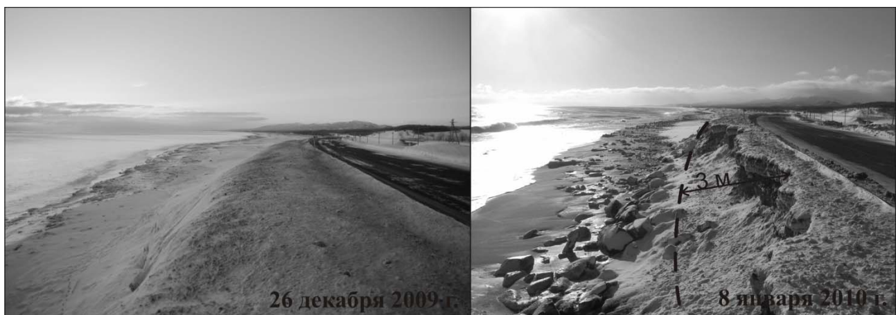
Рис. 2. Пример размыва насыпи автодороги в течение одного шторма на участке 106 км автодороги Южно-Сахалинск-Оха
