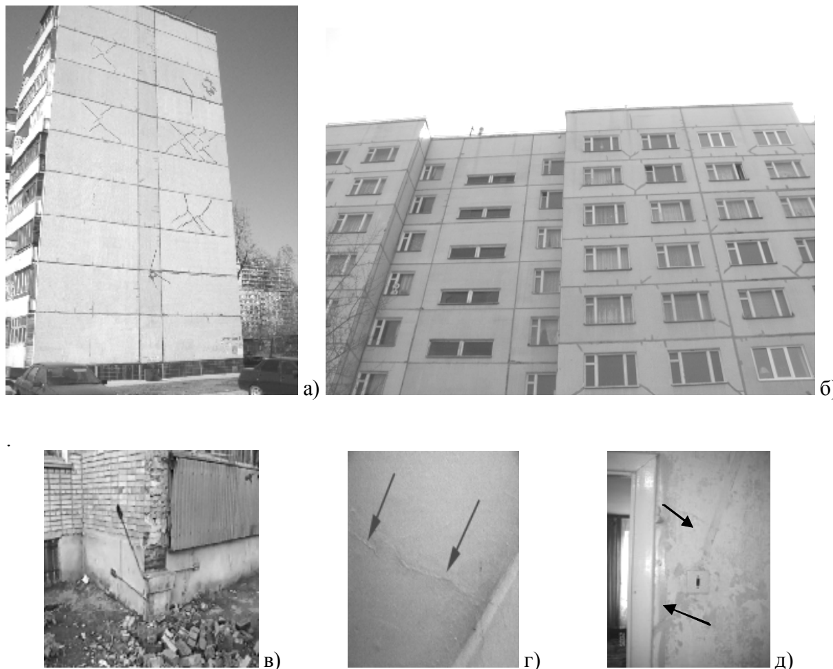
Рис. 2. Характерный вид разрушений строительных конструкций домов в районе Жигулевской ГЭС:
