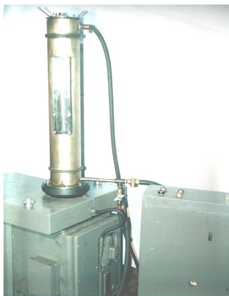
Рис. 2. Установка для промывки масляных фильтров
