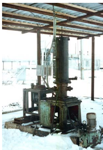
Рис. 3. Фото установки для переработки нефтяных шламов
