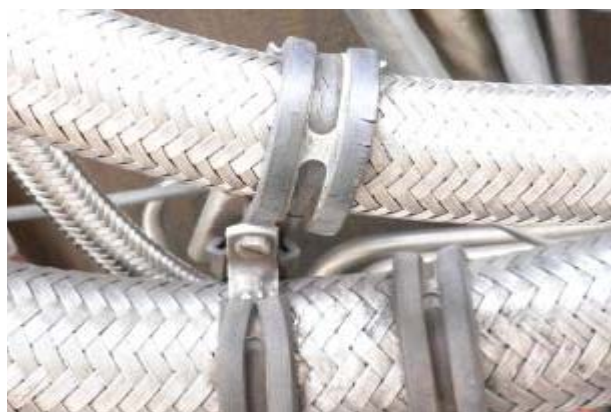
Рис. 2. Крепления с резиновыми уплотнениями с неисправностями, выявленными в процессе эксплуатации
