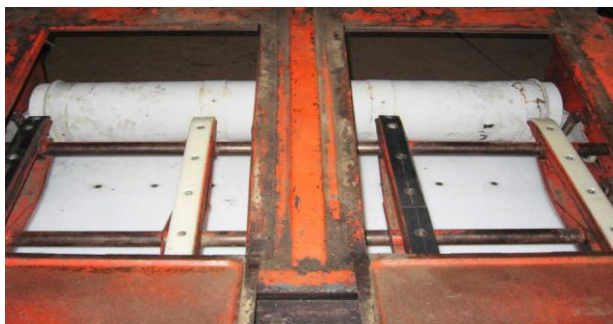
Рис. 1. Накладки до замены
