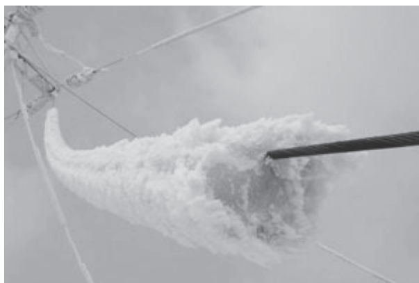
Рис. 1. Фото обледенения проводов ЛЭП
