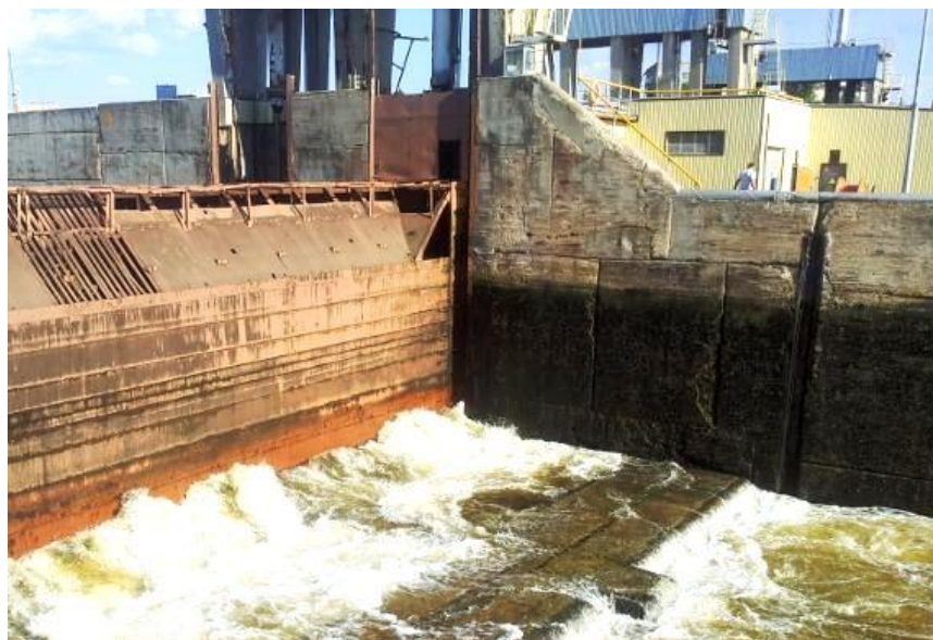
Рис. 1. Групповой гидропривод в составе верхних подъемно-опускных ворот судоходного шлюза
