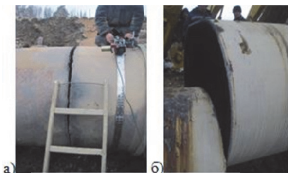
Рис. 3. а) Авария на МГ «Челябинск-Петровск» как результат воздействия изгибных напряжений; б) положение надземного перехода после резки с целью снятия изгибных напряжений
